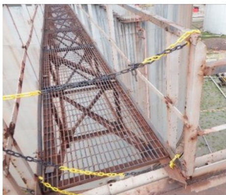
a) Corrosão em passadiço
