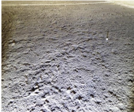
Figura 24 - Aspecto típico do processo corrosivo nas chapas de fundo.
