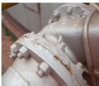
a) Corrosão discreta no flange
