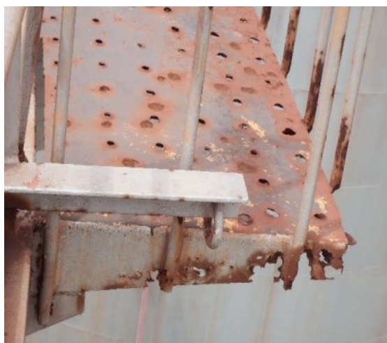
Figura 20 - Vista da degradação da plataforma.
