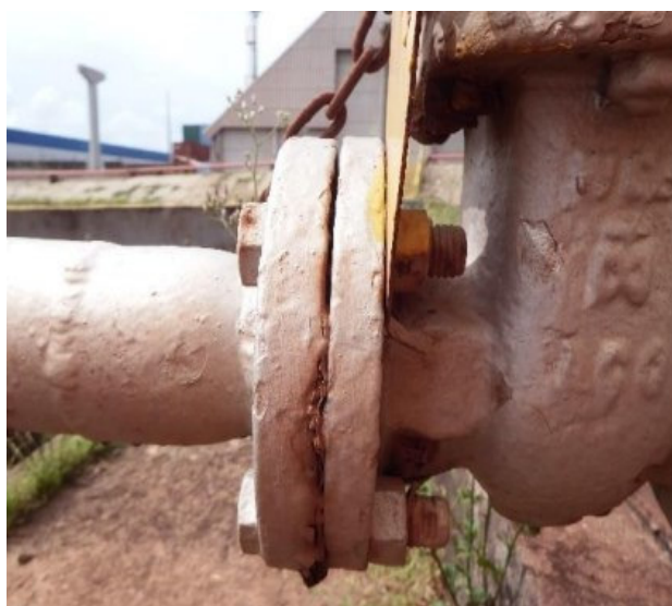
Figura 29 - Detalhe da corrosão no flange.
