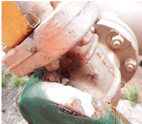
Figura 30 - Corrosão na válvula da conexão de saída.
