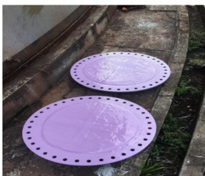
a) Tampas das bocas de visita
