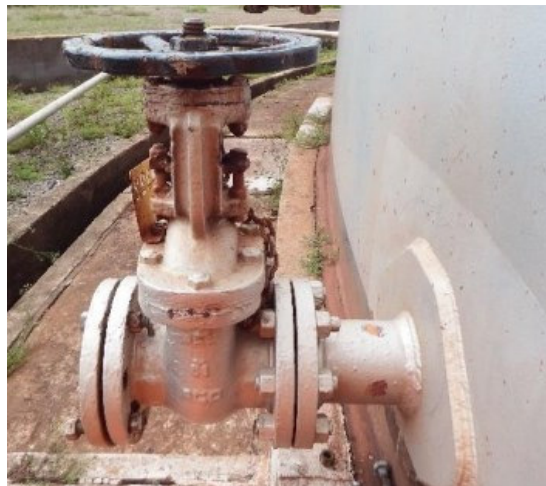
Figura 31 - Vista da corrosão na válvula da conexão de saída.
