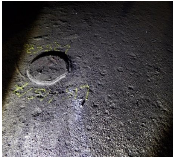
Figura 38 - Corrosão alveolar de média intensidade nas chapas centrais de fundo.
