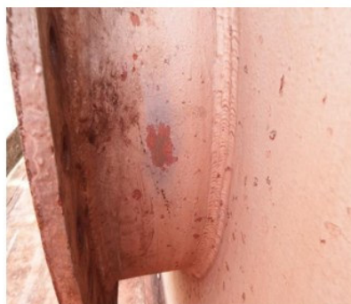
b) Corpo da boca de visita apresentando corrosão
