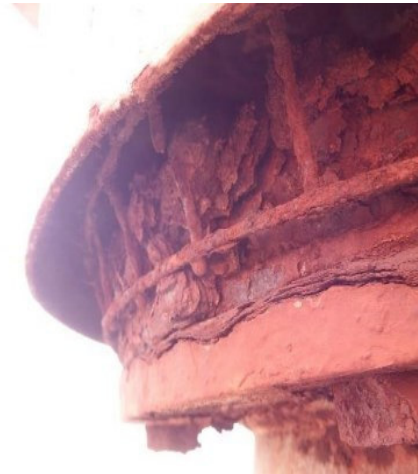
Figura 37 - Corrosão severa por placas no respiro obstruindo a passagem de ar.
