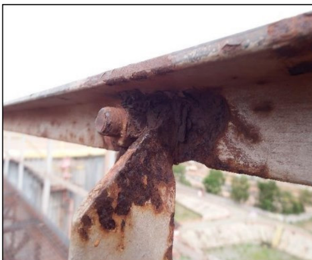
Figura 16 - Corrosão do guarda corpo do passadiço.
