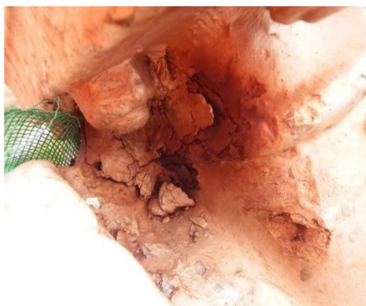
Figura 41 - Corrosão alveolar severa.
