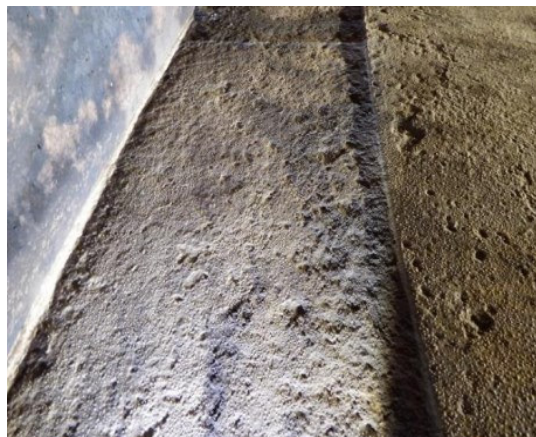
Figura 40 - Corrosão alveolar generalizada severa.
