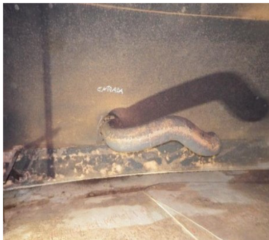
Figura 26 - Corrosão de média intensidade na tubulação de entrada.
