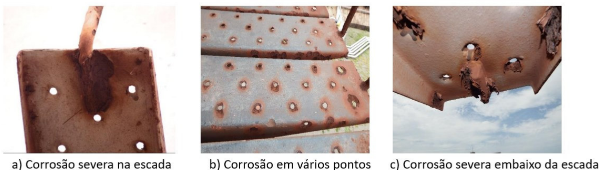
Figura 19 - Corrosão severa em vários pontos na escada.
