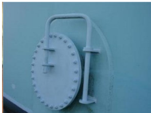
Figura 8 - Boca de visita do costado
