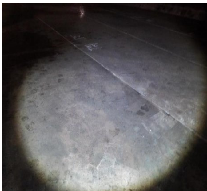
Figura 22 - Detalhe da pintura com corrosão.
