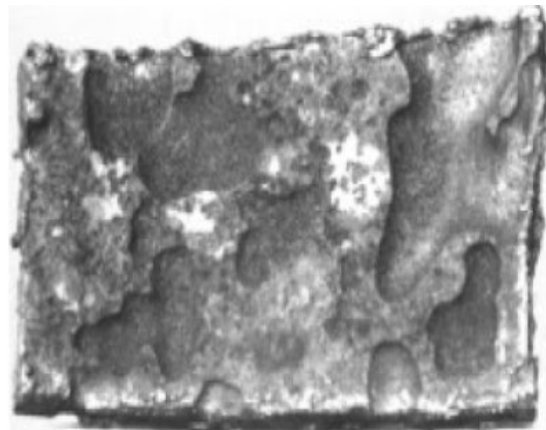
Figura 11 - Corrosão em placas de aço carbono de costado de tanque.
