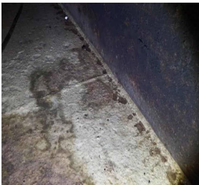
Figura 23 - Desprendimento da pintura.
