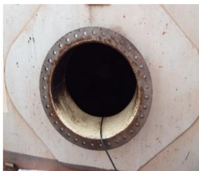
a) Vista da boca de visita
