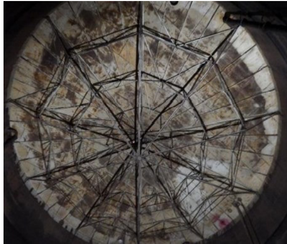
Figura 27 - Corrosão de média intensidade nas vigas radiais.
