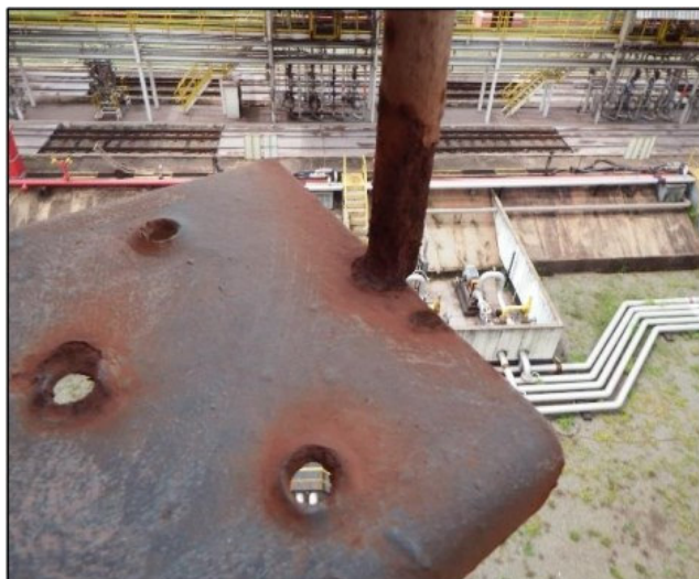
Figura 15 - Perda de seção metálica no guarda corpo.
