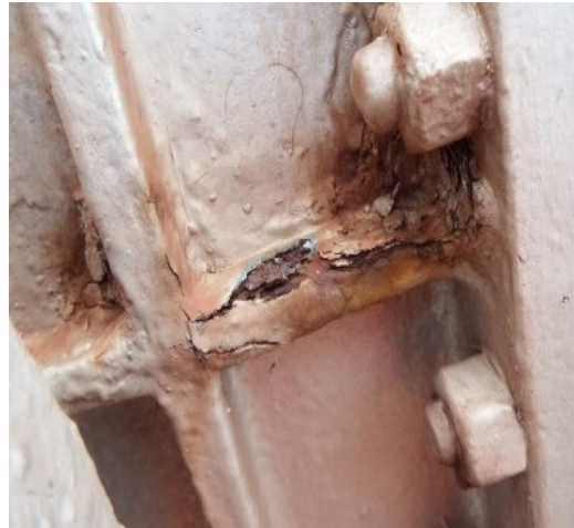
Figura 36 - Corrosão por placas em válvula gaveta.
