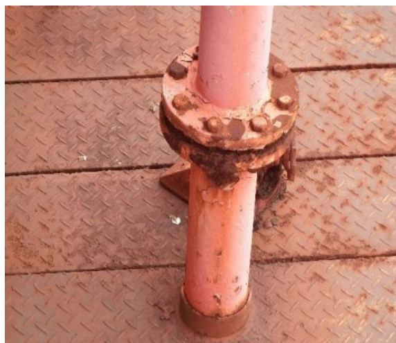
Figura 33 - Corrosão por fresta, ataque severo.
