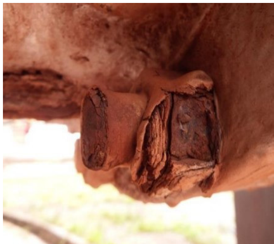
Figura 35 - Corrosão severa por placas no parafuso.
