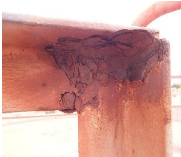
Figura 34 - Corrosão por placas no travessão.
