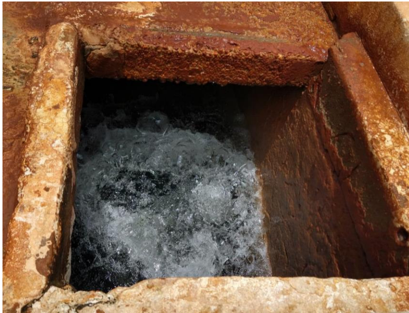
Figura 7. Local onde é realizado a decantação.
