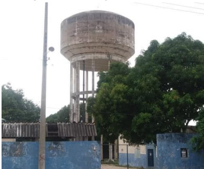
Figura 9. Reservatório de água com 750 mil Litros.
