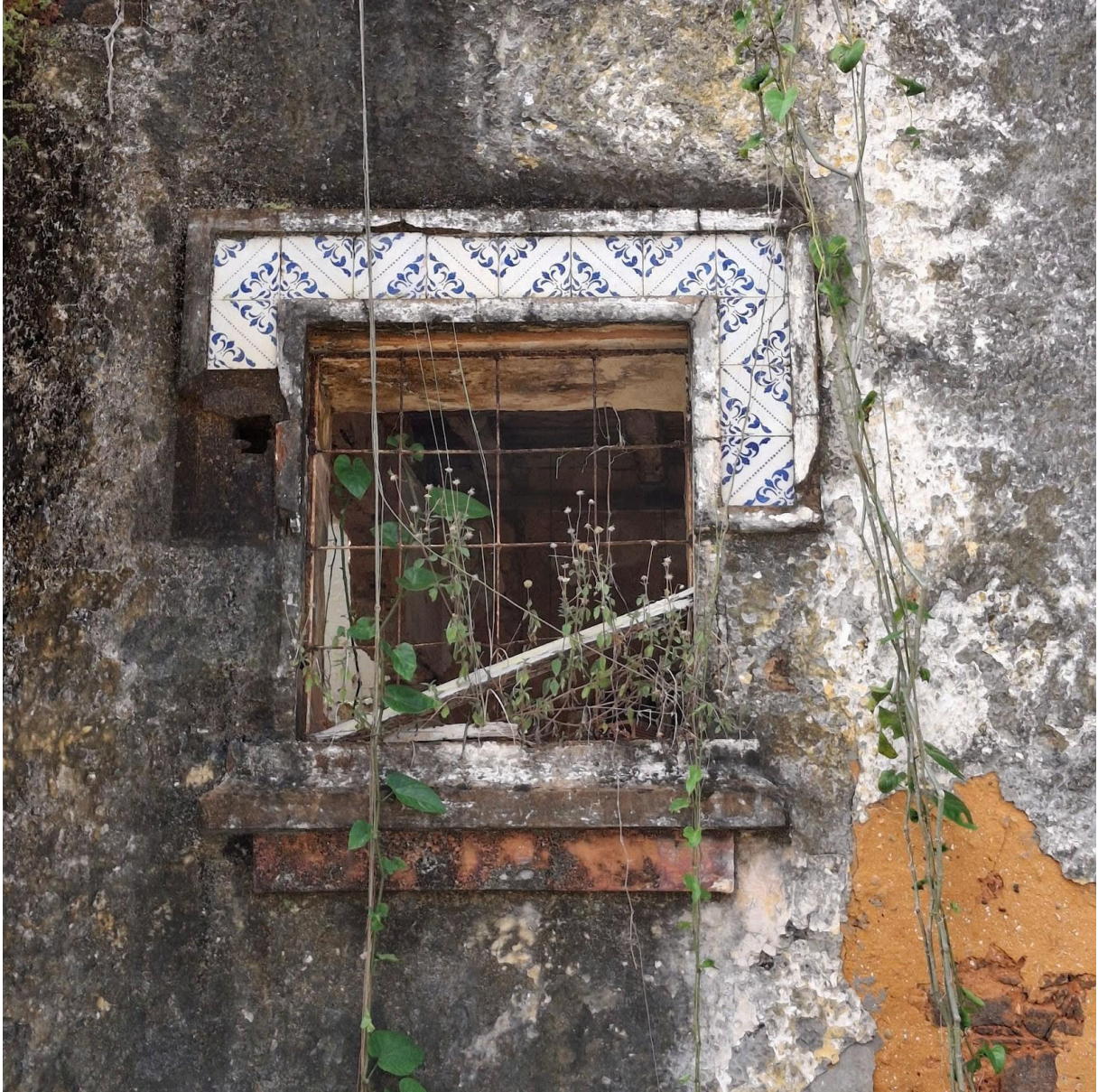
Figura 18: Azulejos e fachada danificados na rua do Egito
