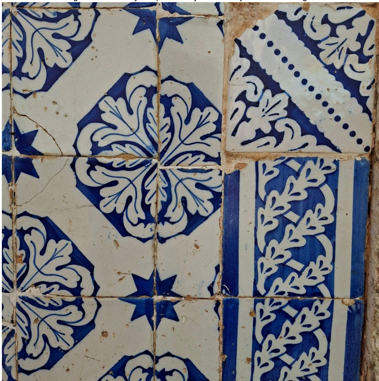
Figura 15: Diferença na padronização de azulejos na Rua Portugal
